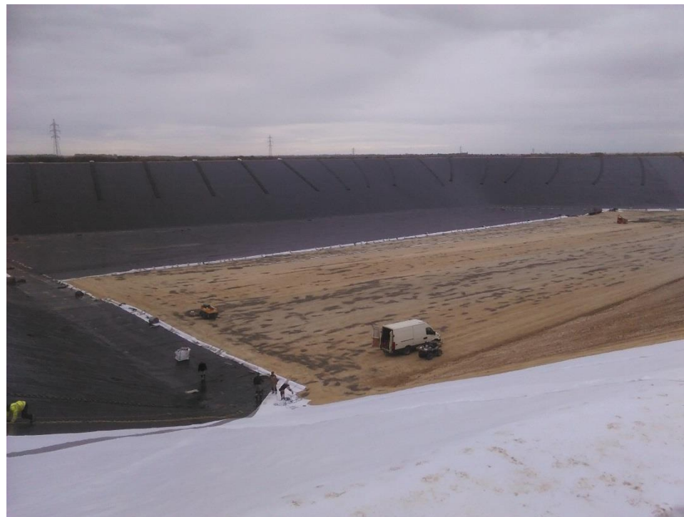
Figure 45 : pose de la géomembrane EPDM - réserve de Saint Benoist sur Mer (novembre 2016)
